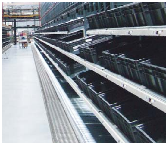
Zone de préparation dynamique pour les références à moyenne et forte rotation.
